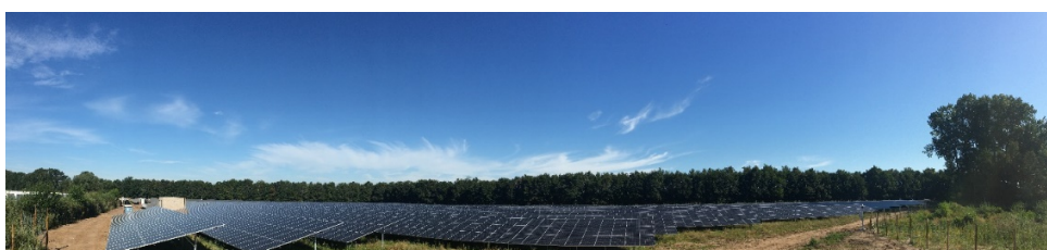
Onderschrift bij foto 1 & 2: BELECTRIC neemt zonnepark Hof van Twente in beheer
